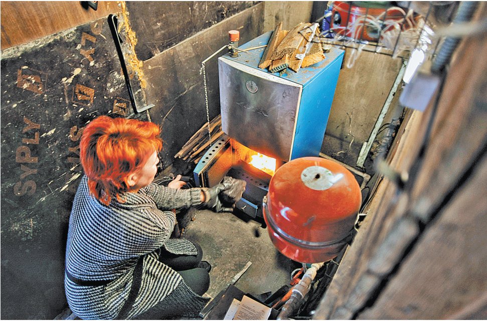
Юноше на коляске к отопительному котлу вообще не подобраться.
